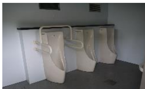
出所：監査人撮影（令和3年9月6日）
