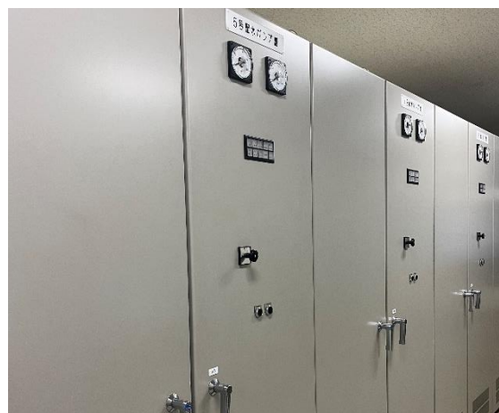
No. 8 動力設備
