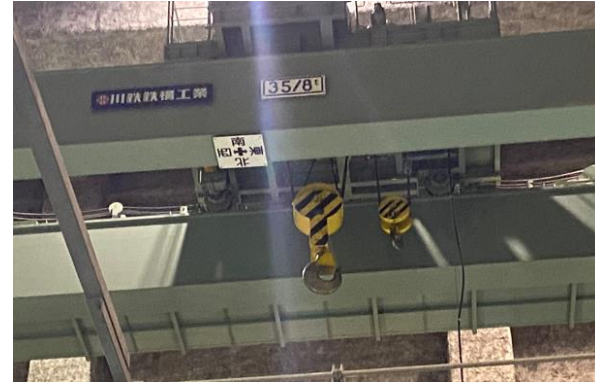
No. 16 原動機室天井クレーン
