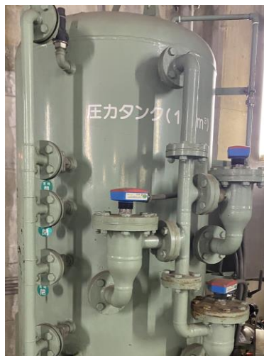
No. 20 洗浄水圧力給水装置
