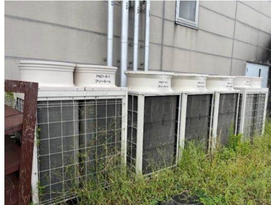
No. 6 アクアリンクちば空調設備外改修工事 監理業務委託
