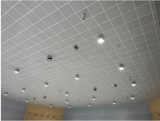
No. 9 アクアリンクちば吊り天井落下対策電気設備工事
