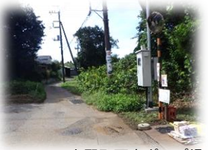
中野町雨水ポンプ場
