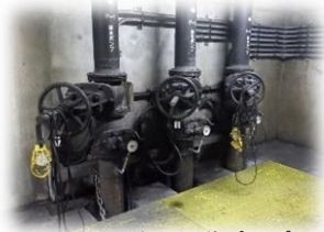
駅前地下道ポンプ場
