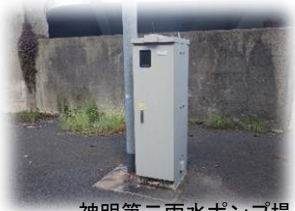
神明第二雨水ポンプ場
