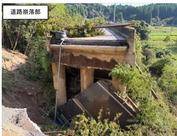
【台風25号による被災状況】
