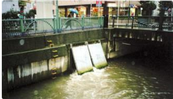
葎川富栄橋付近での雨天時の雨水吐からの放流状況
