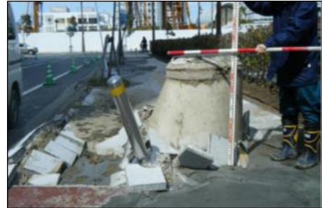
東日本大震災被災状況（美浜区）
