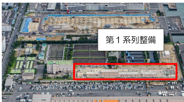
中央浄化センター
