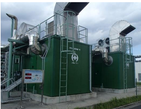
消化ガス発電設備
