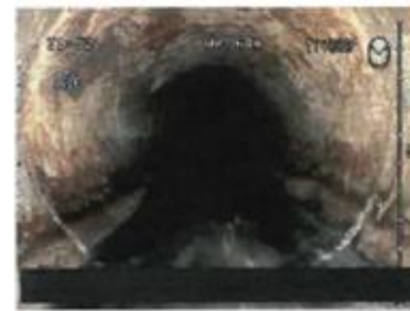
写真1 腐食（表面荒れ）
