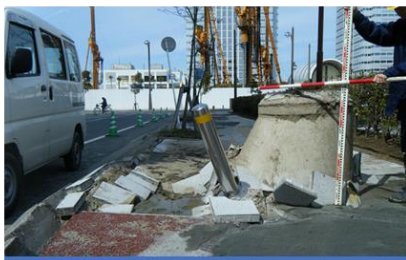
液状化被害（実績）
