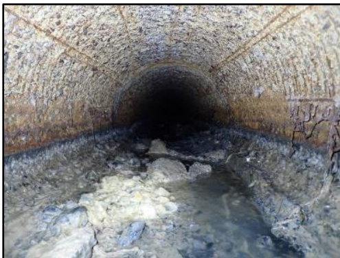
腐食した管きよ
