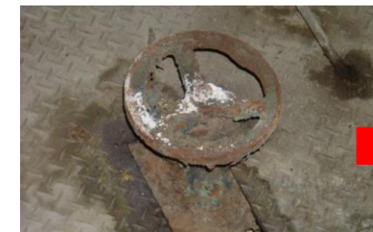
老朽化した設備
