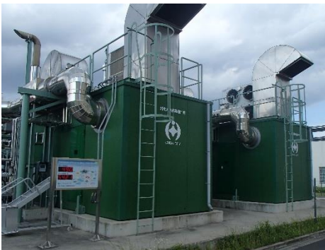
消化ガス発電設備
