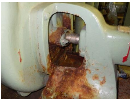
ケーシング部分の腐食
