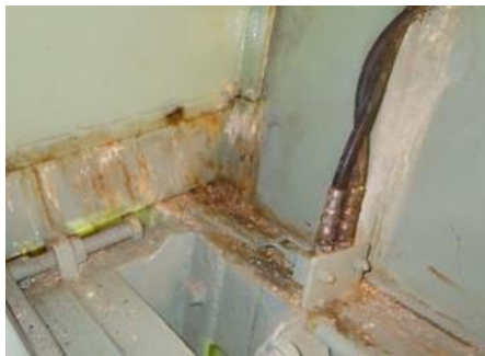
ケーシング部分の腐食
