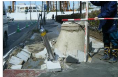
東日本大震災被災状況（美浜区）
