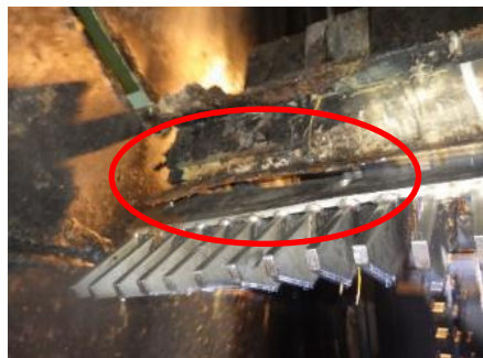
レーキ部分の腐食、変形
