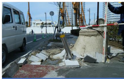
液状化被害（実績）
