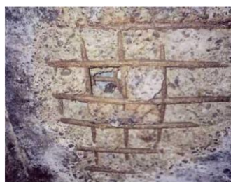
緊急度 I (腐食)
