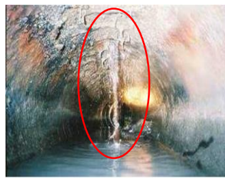
緊急度 II (浸入水)
