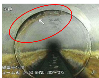
緊急度 II (破損)
