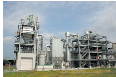
⑨ 汚泥焼却設備
