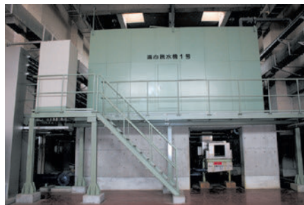
② 汚泥処理棟（汚泥脱水設備）
