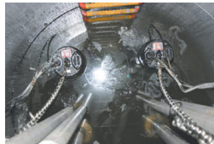
マンホールポンプ
