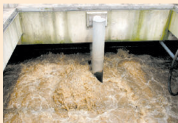
高度処理施設（好気槽）
