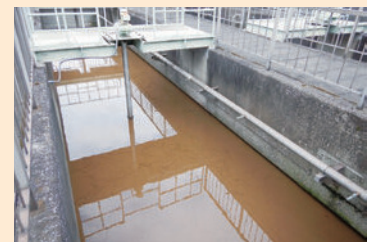
高度処理施設（無酸素槽）
