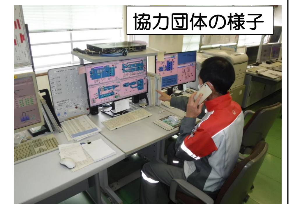
被害状況集計（浄化センター）
