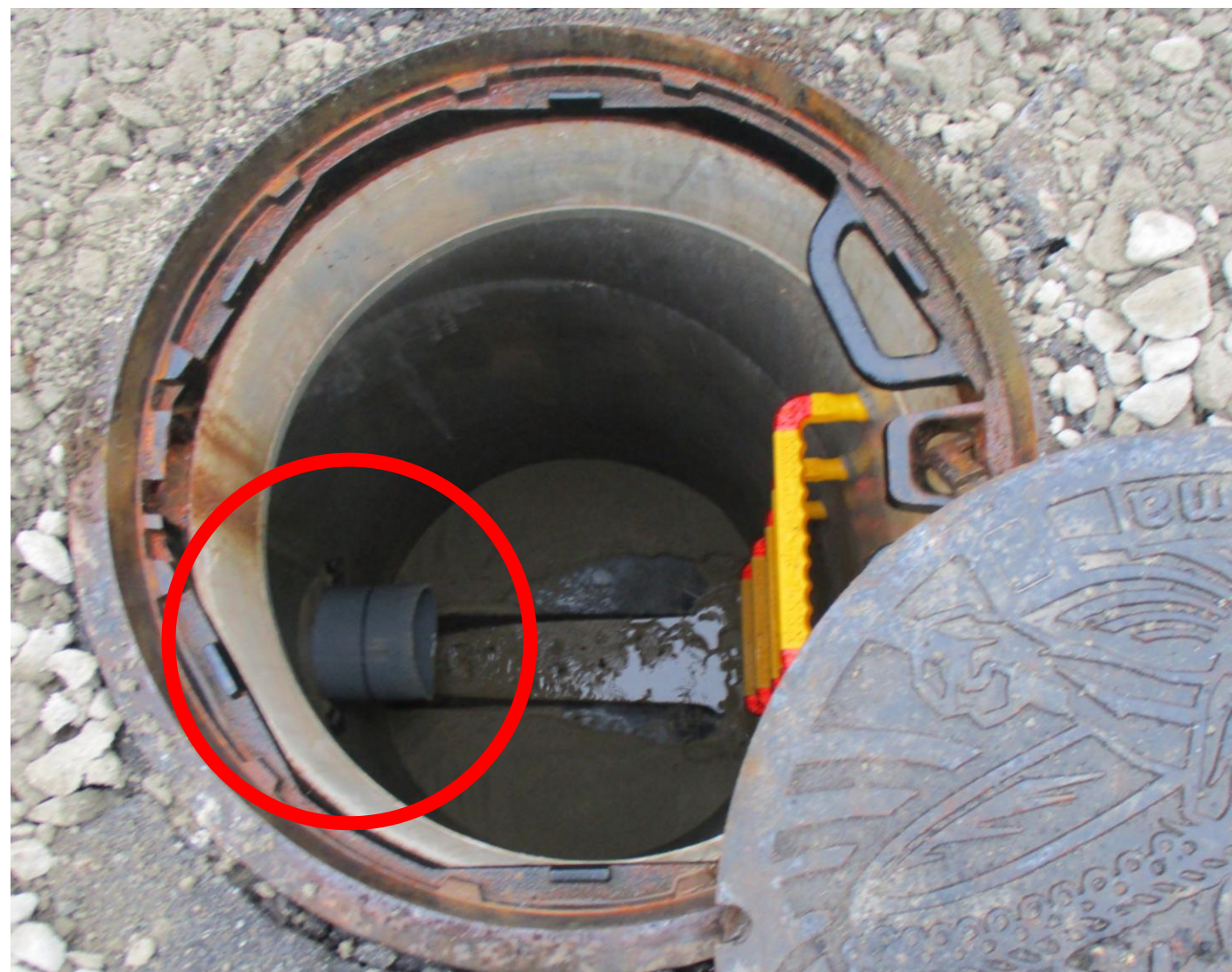
令和6年度能登半島地震（輪島市） 管渠の抜け出し
