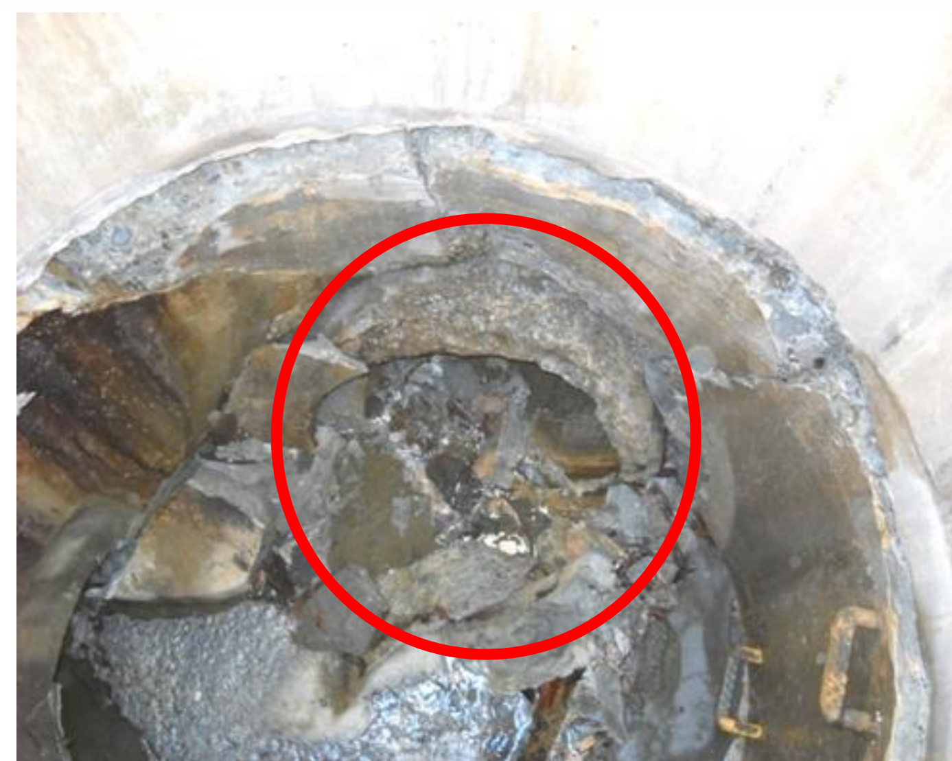
東日本大震災（千葉市） 管渠の抜け出しと躯体の破損
