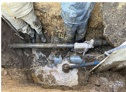
写真 2 - 4 3 汚水管と破損した水道管
