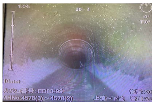
写真 2-29 管内映像(管渠のたるみ)
