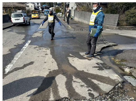
写真 2 - 4 4 水道の漏水状況
