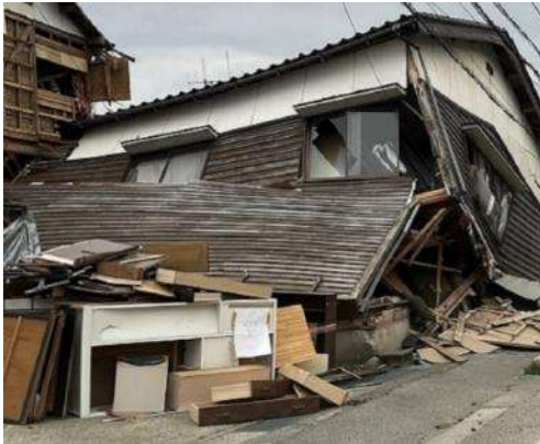
写真1-2 木造建築の倒壊状況① (輪島市内)
