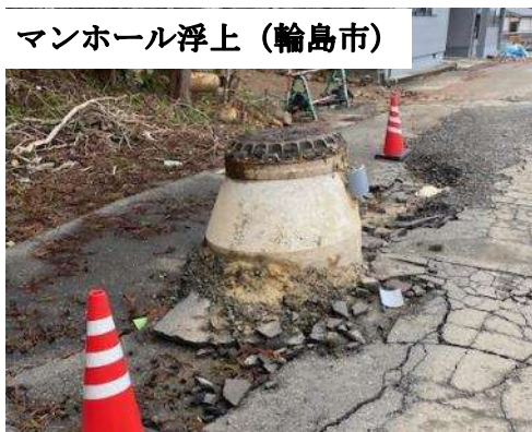
写真1-14 マンホール浮上
