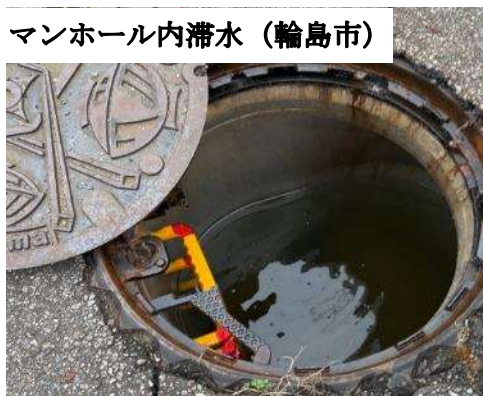
写真1-15 マンホール内滞水状況
