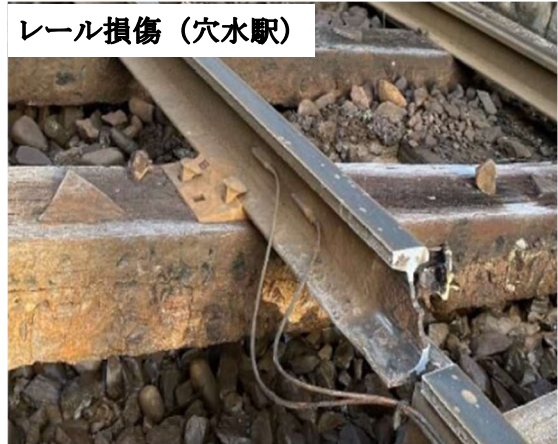
写真1-13 鉄道被災状況
