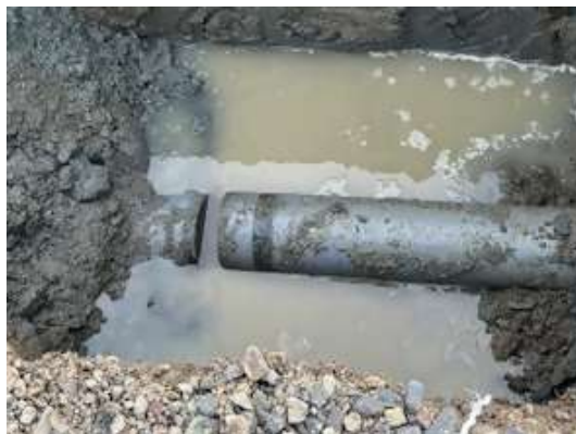
写真 2 - 3 7 管渠の破損状況
