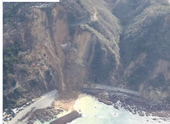
写真1-9 道路被災状況 ②
