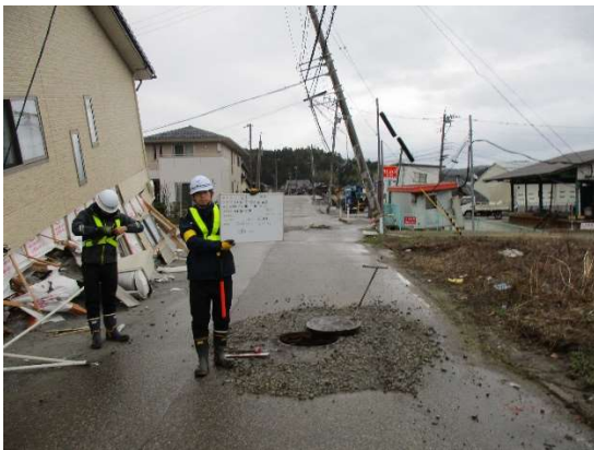
写真 2-21 家屋倒壊付近の調査②
