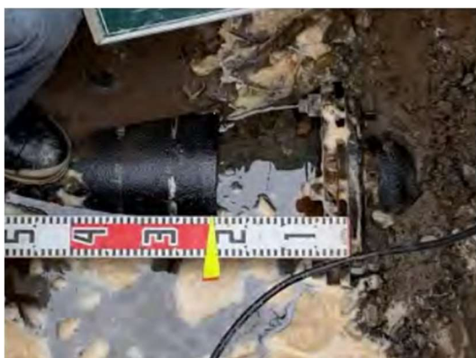
写真1-18 既設圧送管の破損
