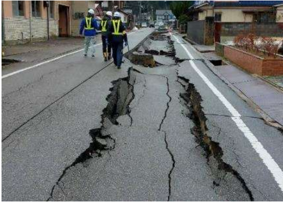
写真1-6 液状化による地表の陥没
