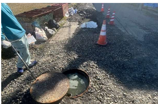
写真 2 - 4 5 管渠の破損、詰まりによる滞水
