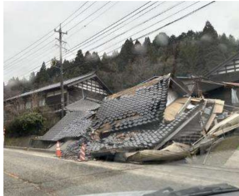
写真1-3 木造建築の倒壊状況② (輪島市内)
