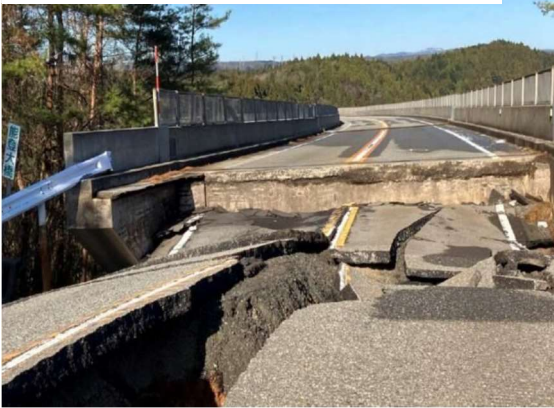
写真1-8 道路被災状況 ①
