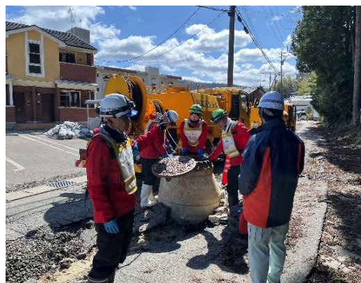
写真 2 - 3 5 液状化現象による人孔浮上
