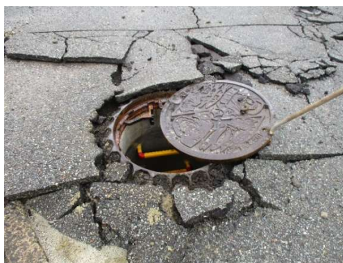
写真 2-25 アスファルト損傷箇所
