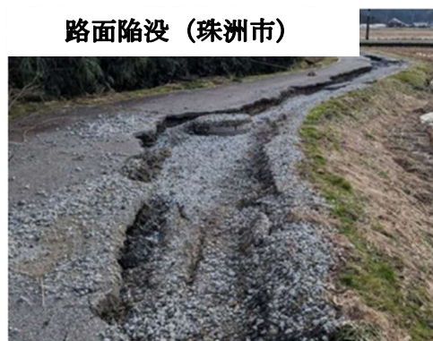
写真1-17 管路埋設部の路面陥没
