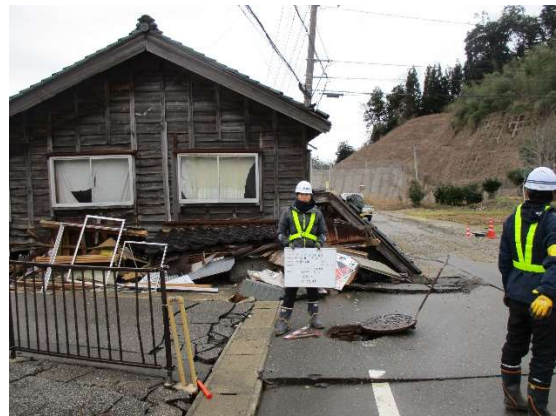
写真 2-20 家屋倒壊付近の調査①
