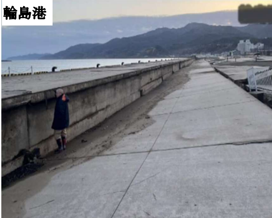
写真1-10 港湾被災状況
