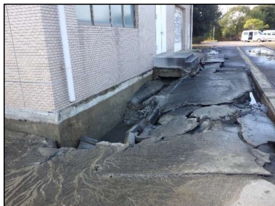
写真3 処理場流入管破断（和倉処理区）
