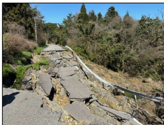
写真6 道路被災状況（能登島町）
