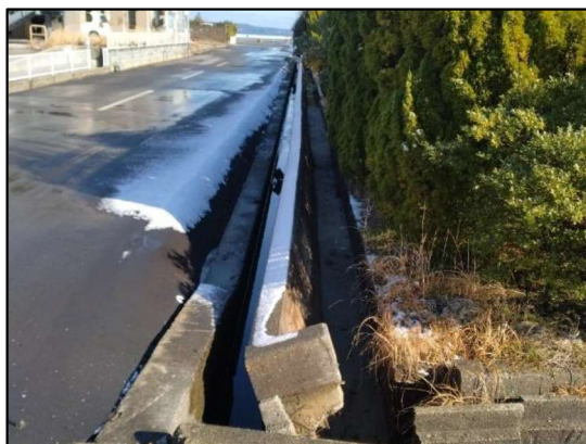
写真5 排水路被災状況（なぎの浦）
