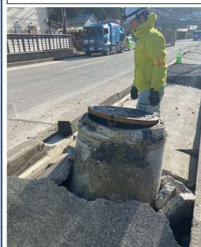
マンホールの浮上
