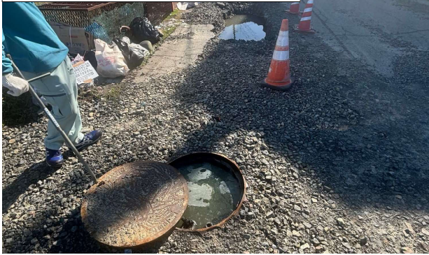
管きよの破損、つまりによる帯水
