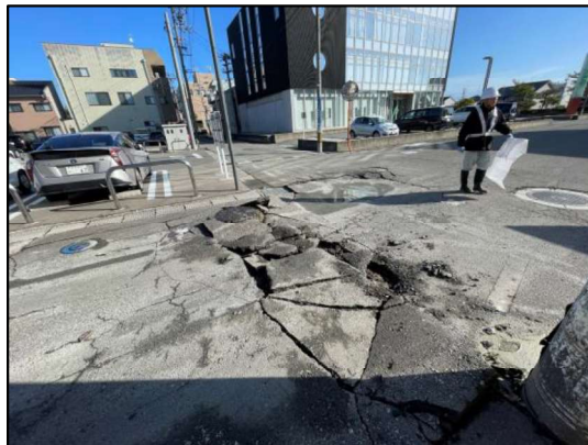
写真2 人孔周囲状況陥没（米町）
