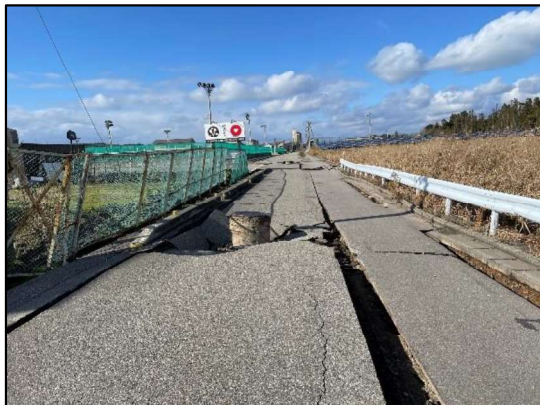
写真1 人孔浮上（石崎町）
