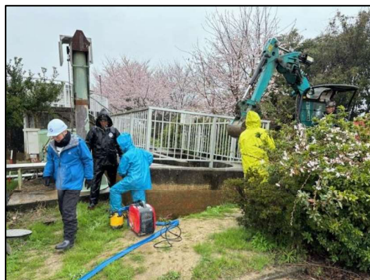
写真4 浄化槽基礎杭破断（田鶴浜処理区）
