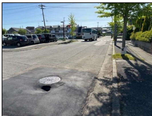
写真9 吸出しによる陥没
