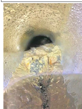
管きょ破損による土砂流入
