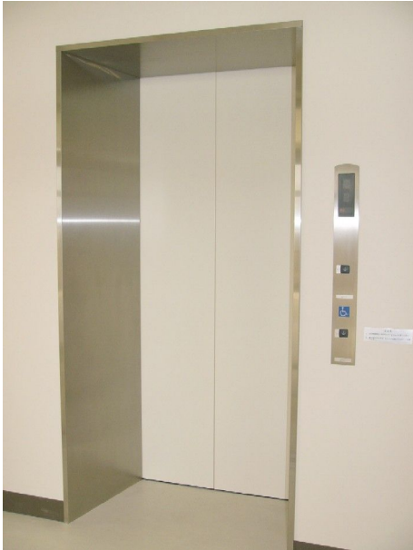
エレベーター
