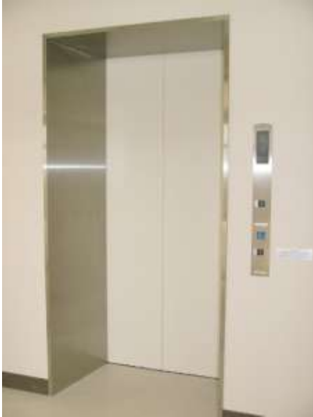
エレベーター
