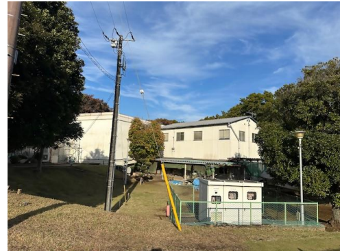
写真 キュービクル
