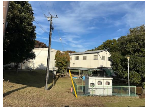
写真 キュービクル
