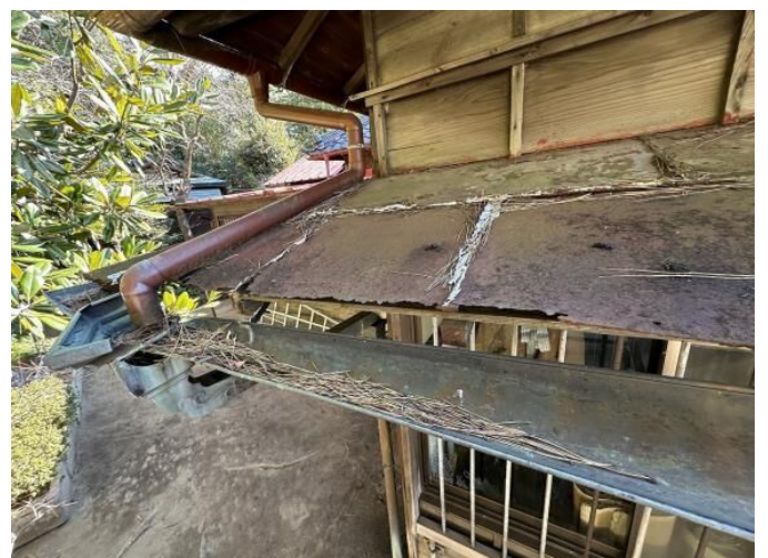
台所庇破損状況
