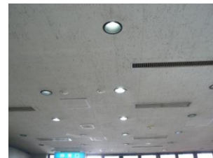
1階ロビーの天井照明
