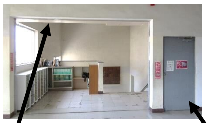
各階段、各階にある防火シャッター
