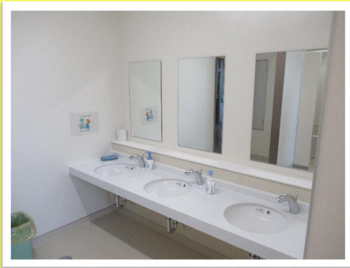
洗面台は自動水栓になりました。
