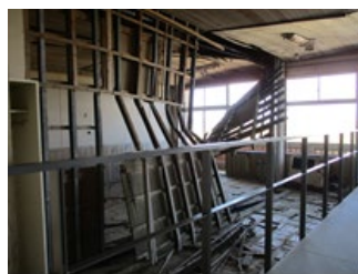
津波により校舎の壁や床が 無残な姿に
