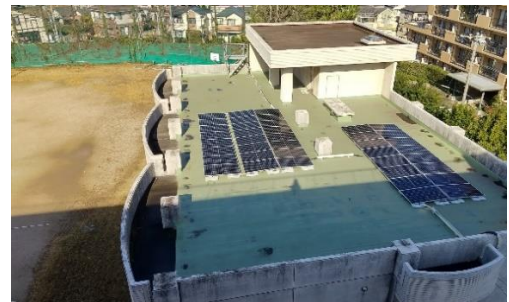
東棟屋上に設置されたソーラーパネル
