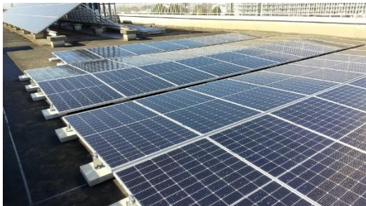
本館屋上に設置されたソーラーパネル
