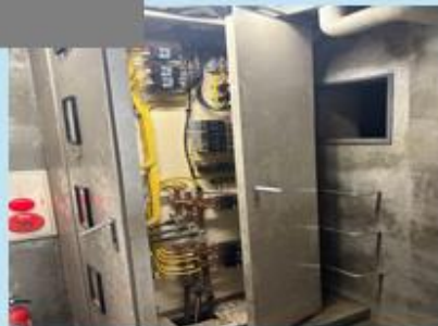
電気設備の浸水 8/13～
