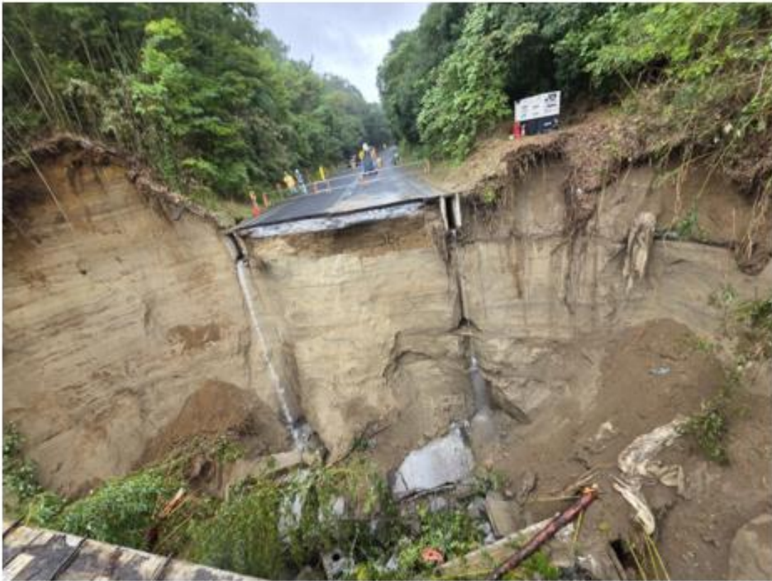
道路崩落 旧千葉外房有料道路
