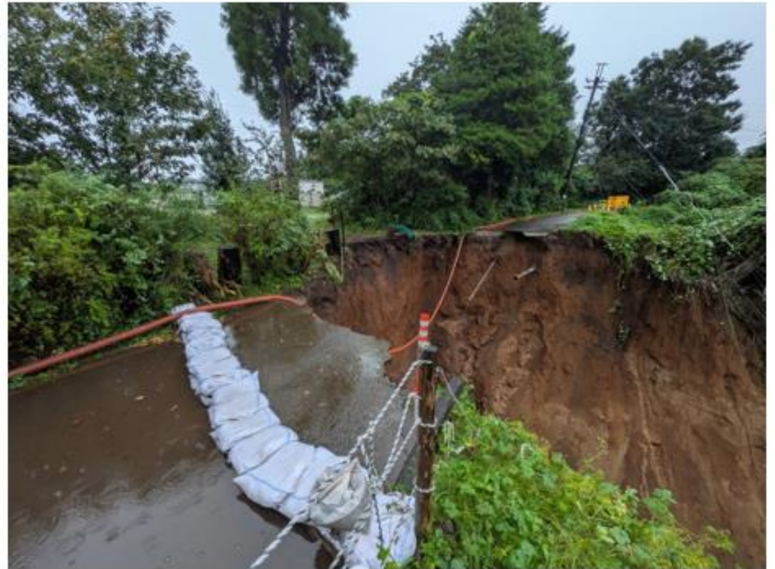
道路崩落 越智町
