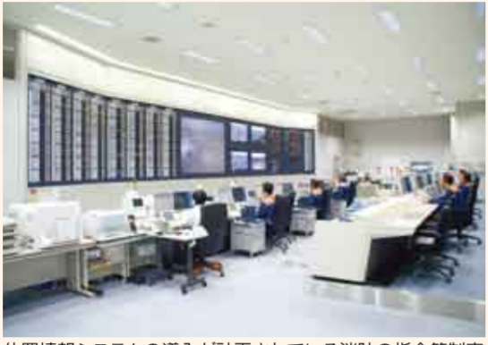
位置情報システムの導入が計画されている消防の指令管制室
