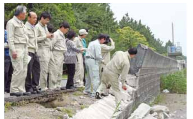
市内被災地の現地調査(花見川河口付近)
