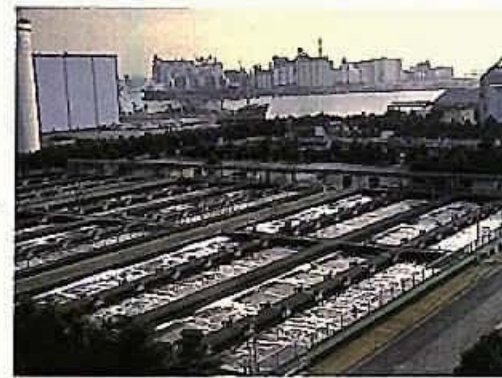
汚水を処理する中央浄化センター
