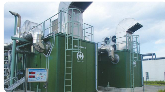
南部浄化センターの下水汚泥を活用した消化ガス発電設備
