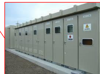
仮設受変電設備
