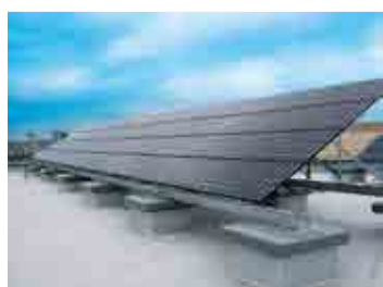
避難所に設置される太陽光発電設備
