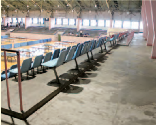
老朽化した千葉公園体育館
