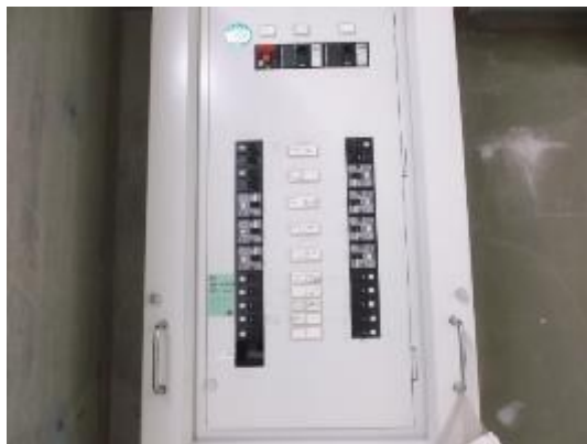
移設の分電盤
