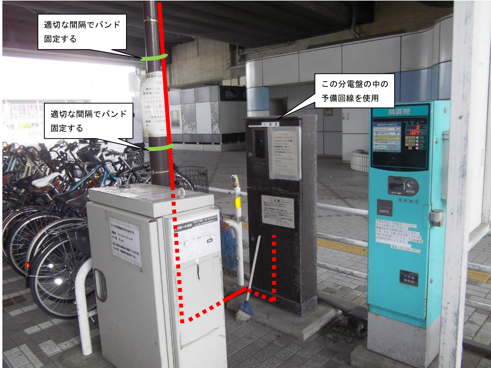
別図3 イ 海浜幕張駅第4自転車駐車場内の照明柱
