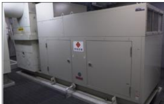
■非常用電源(イメージ)
