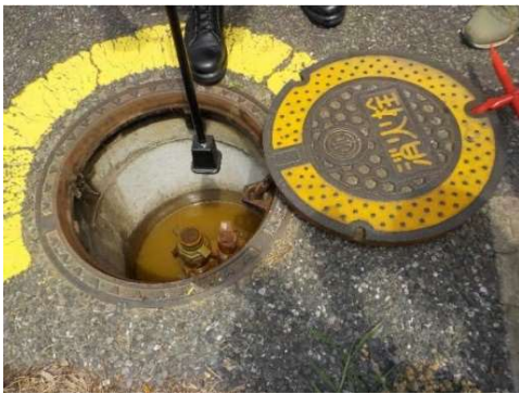
<消火栓の開け方を確認>
