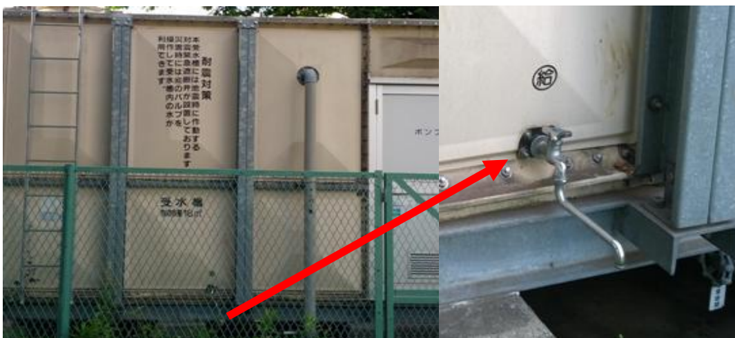
蛇口付受水槽の外観
