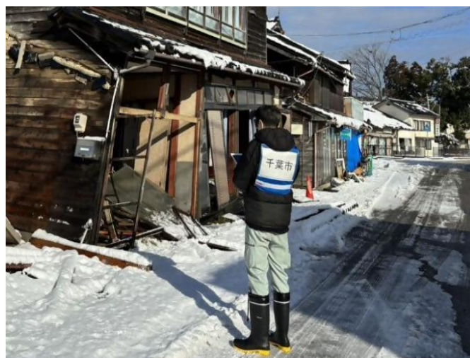
被害認定調査（珠洲市内）
