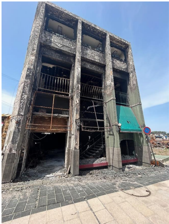
燃烧したビル(輪島市)
