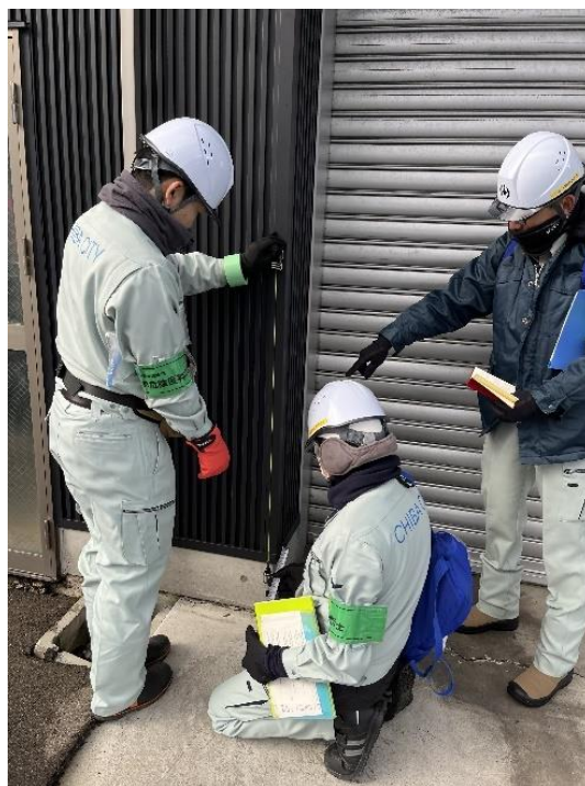
応急危険度判定を実施（輪島市）
