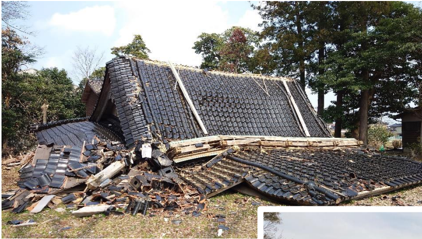
社が倒壊した神社(珠洲市)
