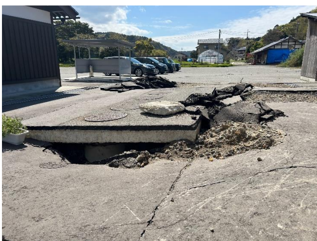
道路の陥没(珠洲市)
