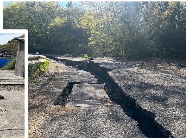
道路のひび割れ(珠洲市)
