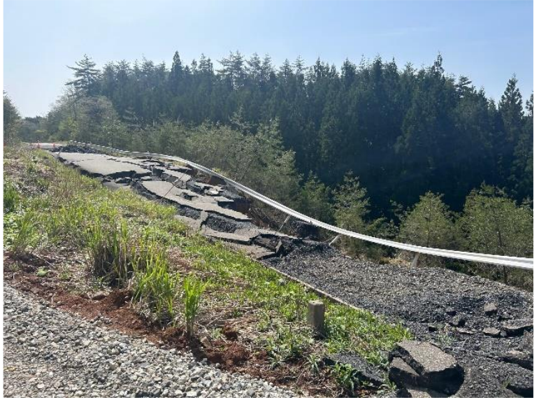
道路の崩落(能登町)
