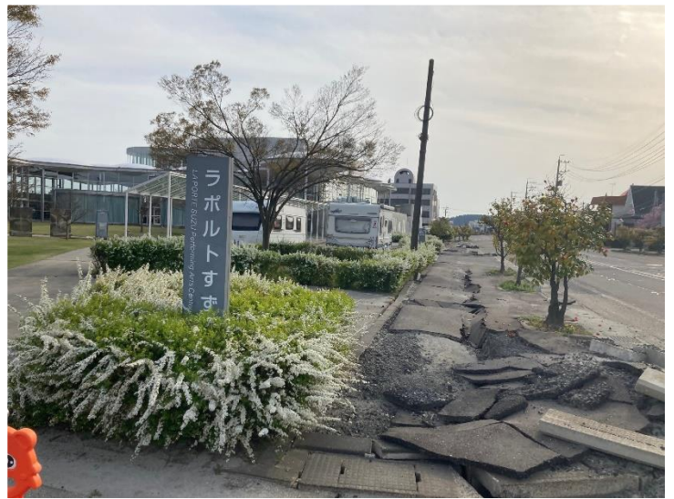
ひび割れや隆起している道路(珠洲市)
