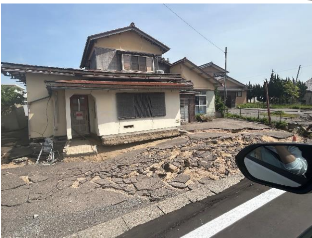
液状化により舗装がはがれた様子(内灘町)
