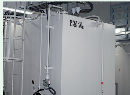
オイルタンク
