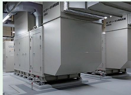
非常用発電機
