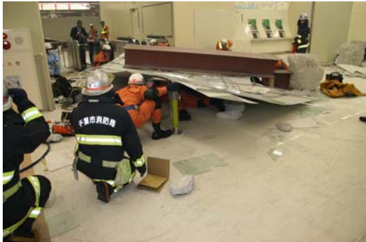
・瓦礫下の被害者の救助
