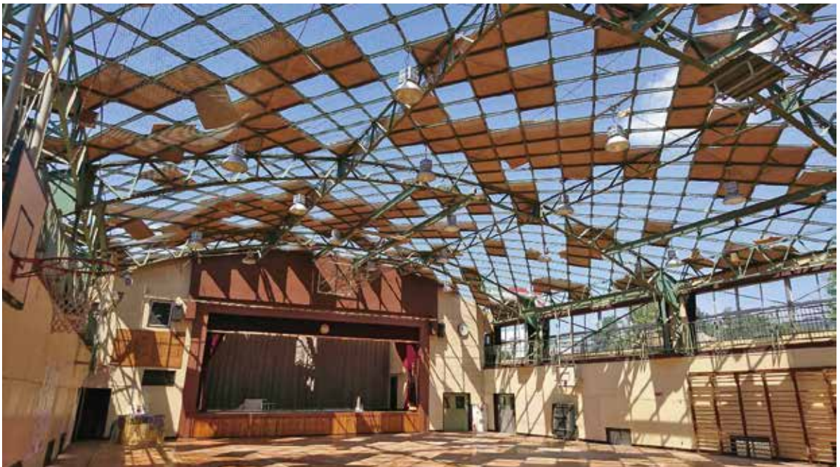
屋根が破損した屋内運動場(稲浜小学校)
