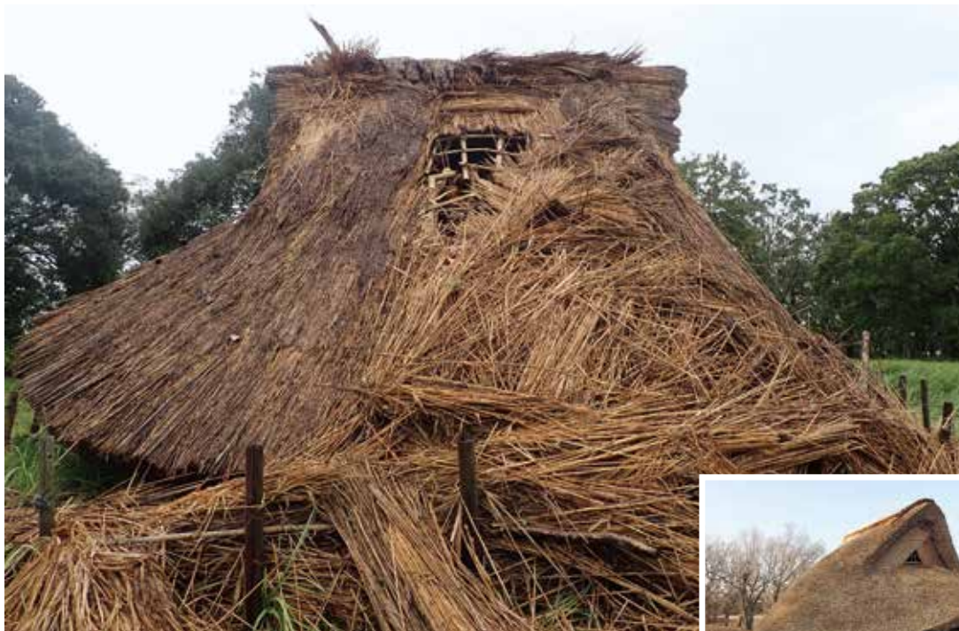
破損した復元住居 (加普利貝塚縄文遺跡公園)
