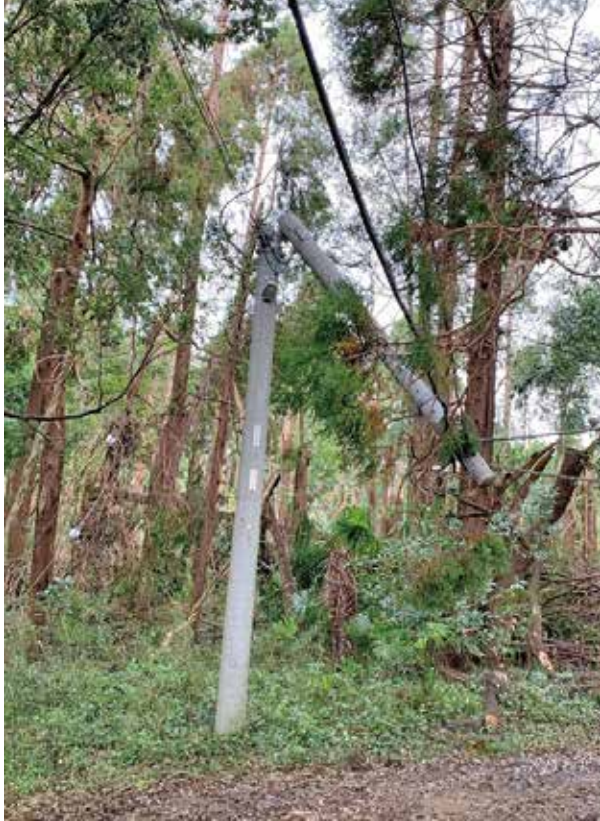
倒壊した電柱(若葉区富田町)
