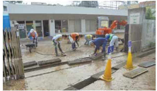
流出した土砂の清掃 (緑区大木戸町)
