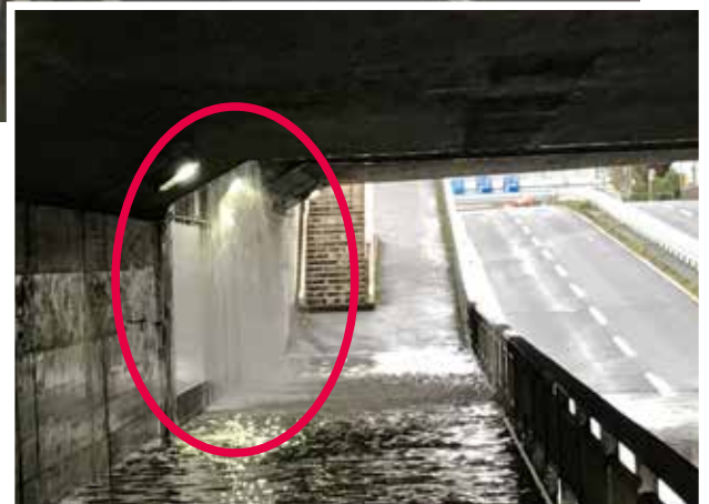
排気施設から生じた大量の溢水が流入した末広地下道 (中央区末広5丁目)
