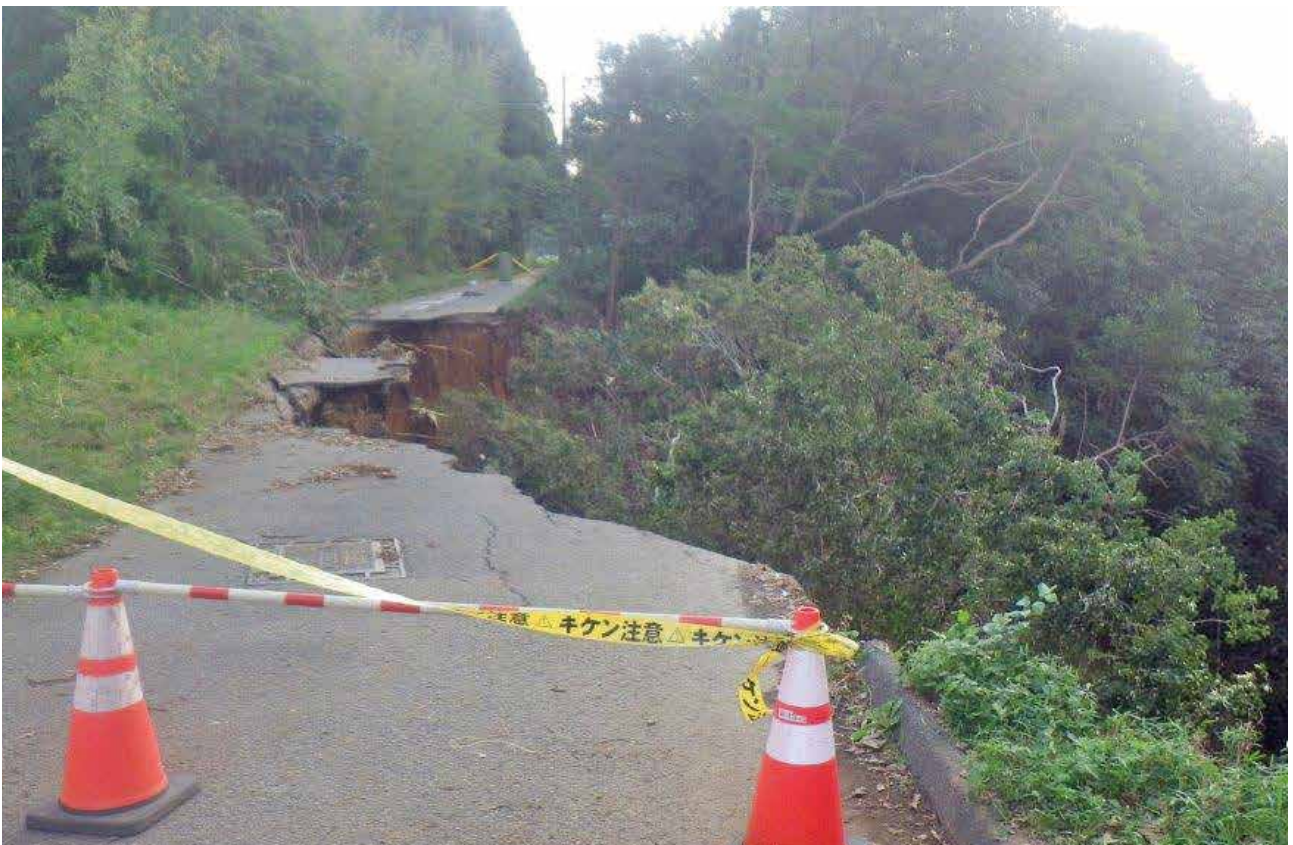
崖崩れにより分断された道路(緑区越智町)
