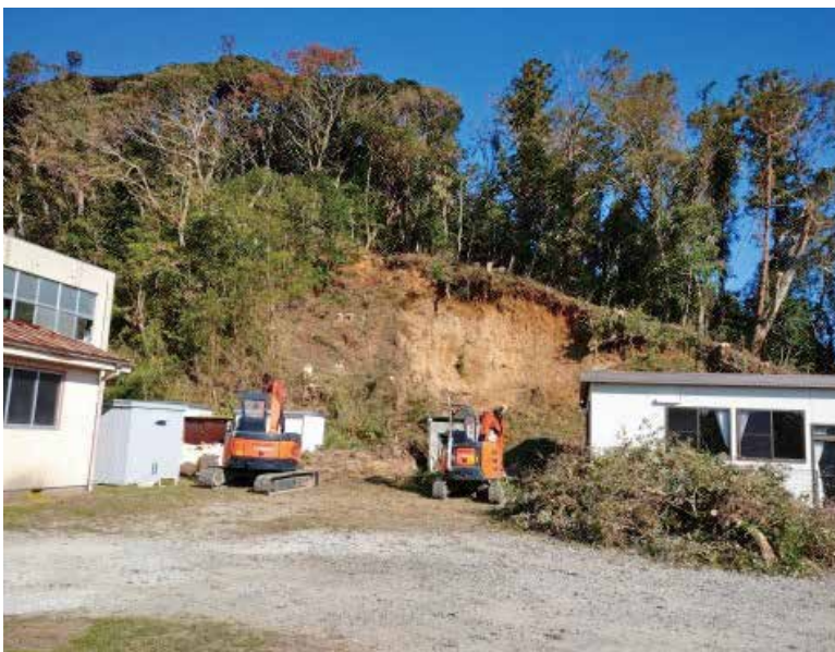
土砂災害現場(椎名公民館裏山)
