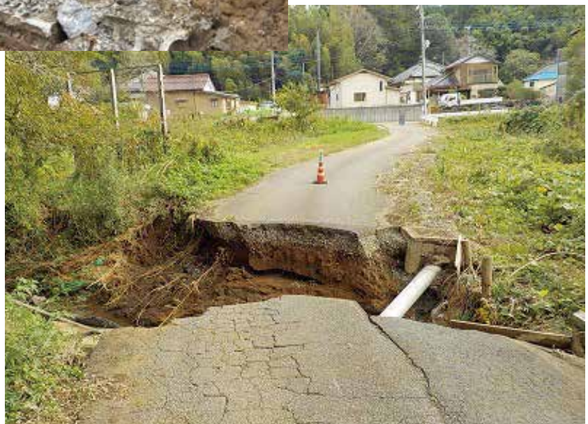
道路下に水路があり、大雨の洪水により分断された道路 (緑区下大和田町)
