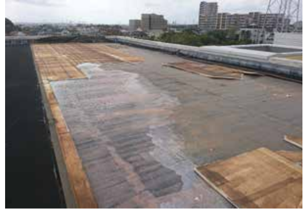
破損した校舎屋上の防水シート、断熱材(金沢小学校)
