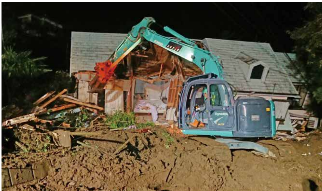
土砂崩れ現場における消防、警察、自衛隊等の救出活動(緑区誉田町3丁目)
