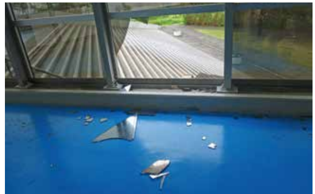
破損した窓ガラス
