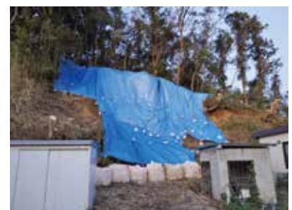
土砂崩れ箇所の応急復旧 【ブルーシート養生、大型土のう設置】 (椎名公民館裏山)
