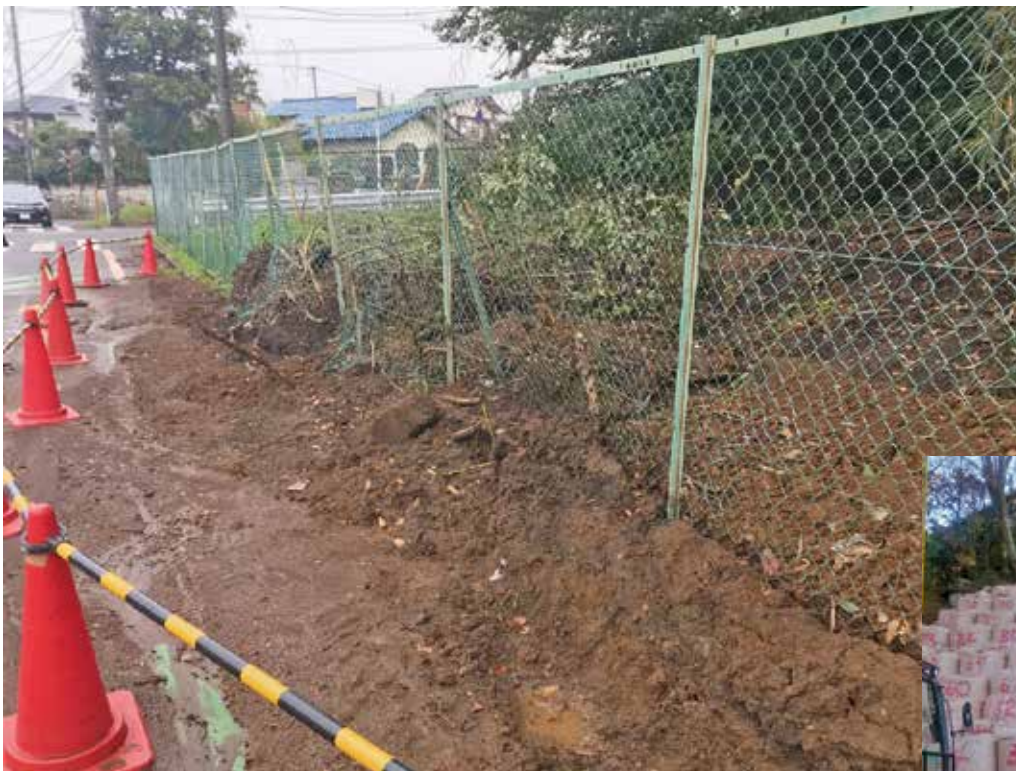
学校敷地内の斜面が崩落(千城台西中学校)
