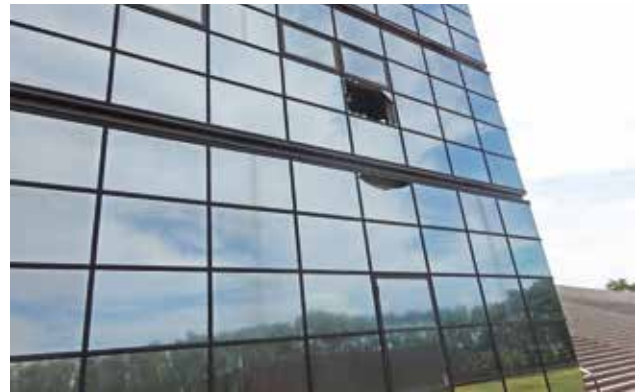
破損した窓ガラス
