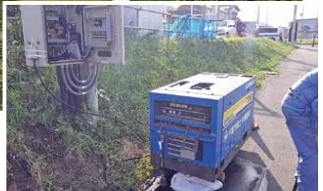
発電機を地下道に持ち込み、道路排水ポンプが稼働(村田町JR内房線地下道)
