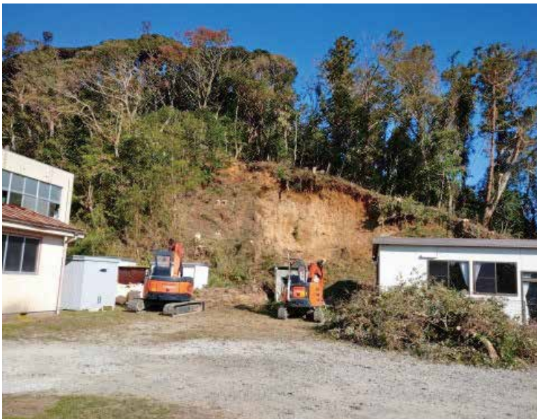
土砂災害現場(椎名公民館裏山)
