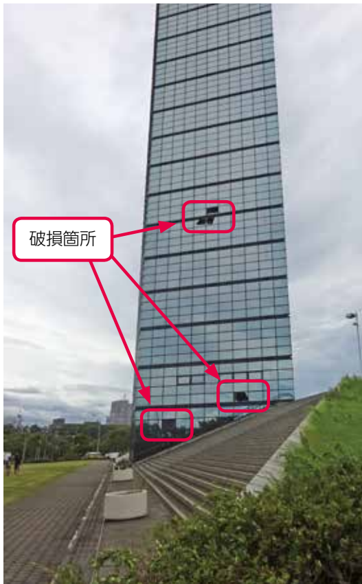
破損した千葉ポートタワーの窓ガラス
