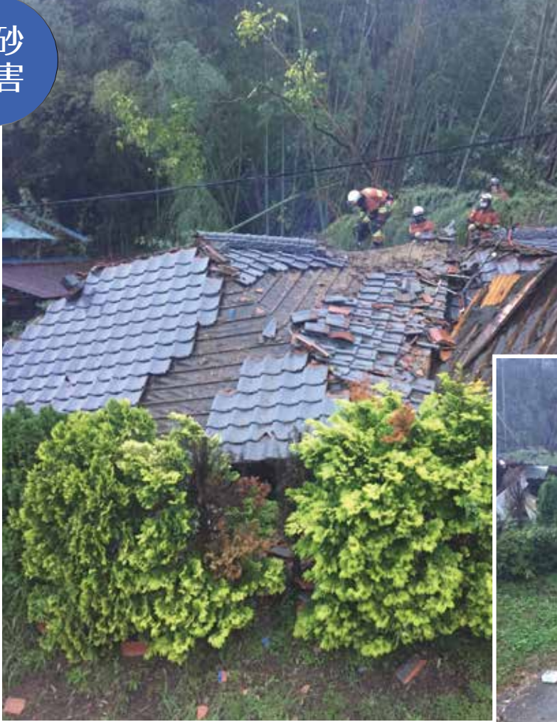
土砂崩れにより倒壊した家屋 (緑区板倉町)
