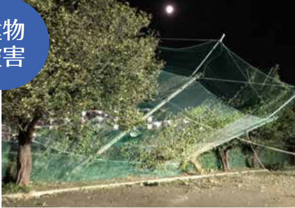
倒壊した校庭のフェンス(草野中学校)
