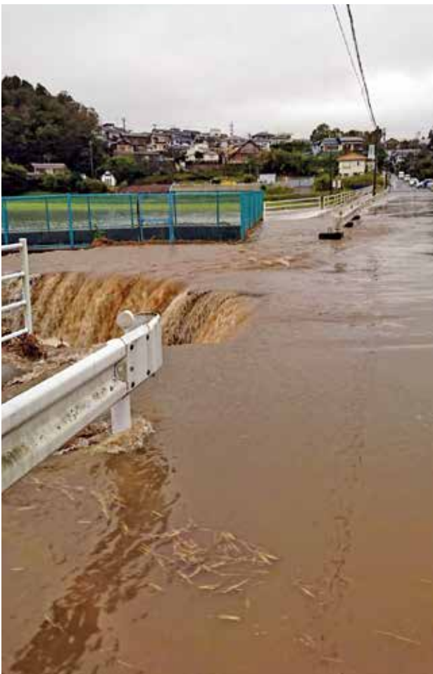
都川の氾濫により、一部崩落した歩道等(若葉区川井町)
