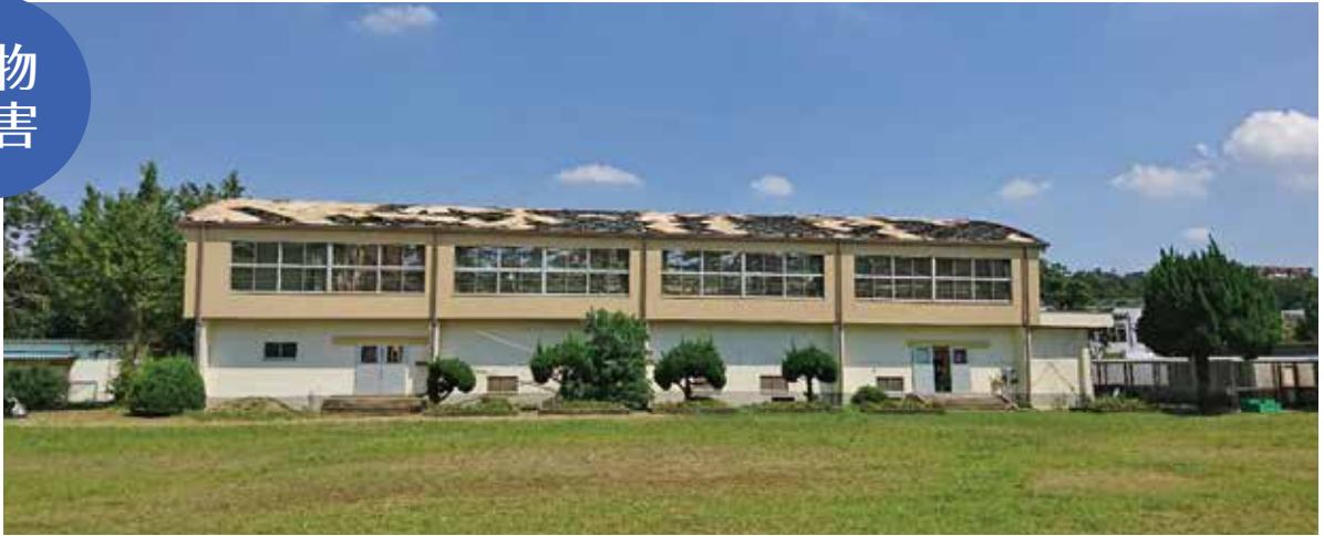
屋根が破損した屋内運動場(稲浜小学校)
