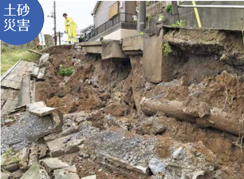
倒壊した道路脇の軽量ブロック (中央区今井町)
