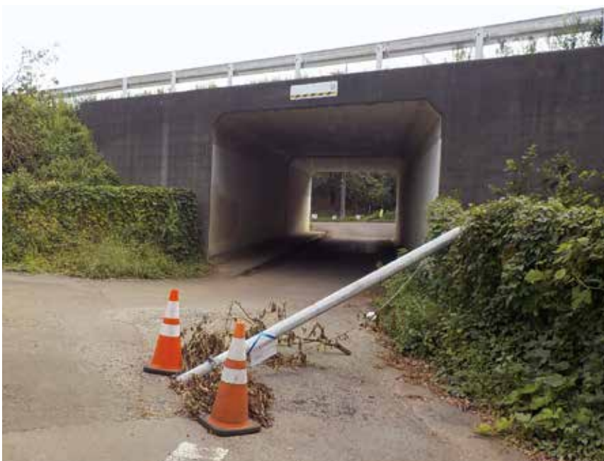
倒壊した電柱 (緑区高田町地内)
