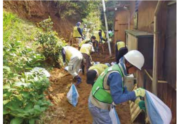
土砂崩れにより流出した土砂の土のう詰め及び撤去 (若葉区野呂町)
