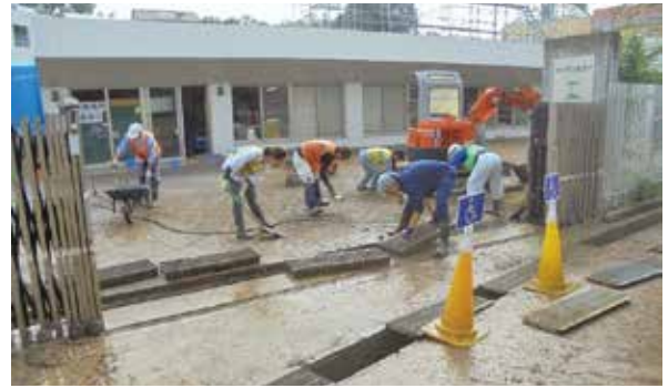
流出した土砂の清掃 (緑区大木戸町)
