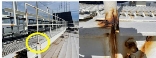
○印 防護柵根元腐食
