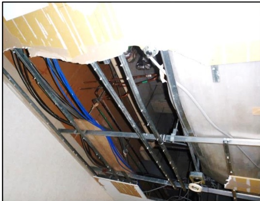
平成28年1月 内視鏡室前廊下 漏水により天井ボード崩落
