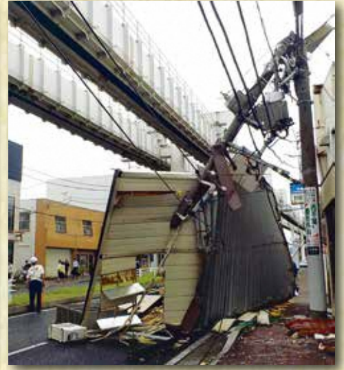
プレハブ・電柱の倒壊(房総半島台風)
