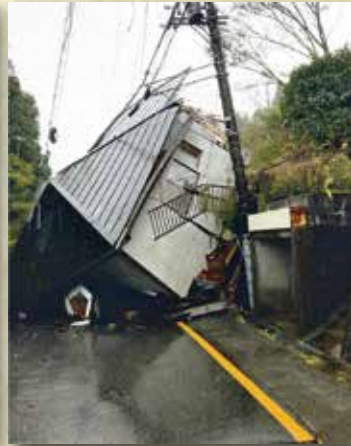
家屋倒壊(10月25日大雨)
