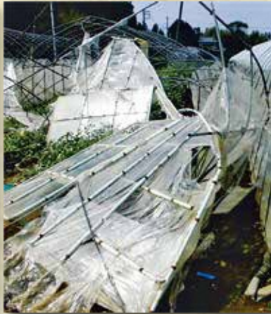
ビニールハウスの破損(房総半島台風)
