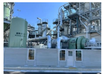
固形燃料化施設完成写真
