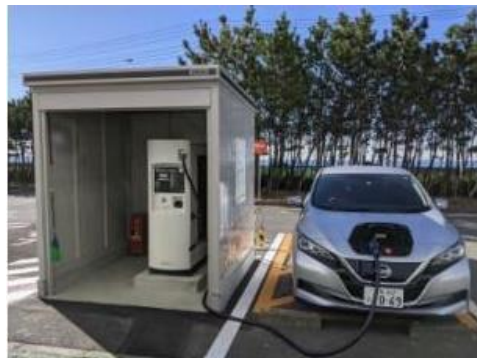
EV充電設備
