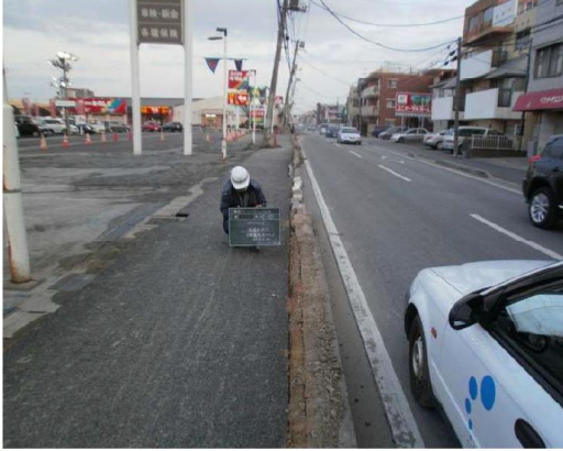
電柱倒壊状況 (東日本大震災)
