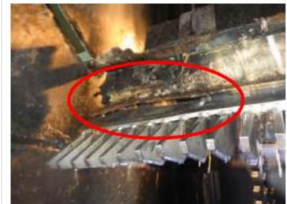
レーキ部分の腐食、変形
