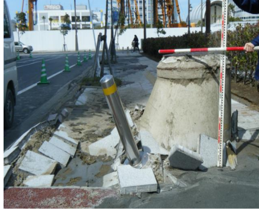
人孔隆起状況 (東日本大震災)
