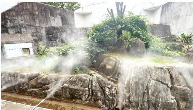
ミストシステム稼働の様子
